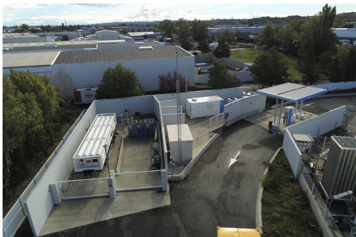
© HYmpulsion, station hydrogène à Saint-Priest, vue aérienne
