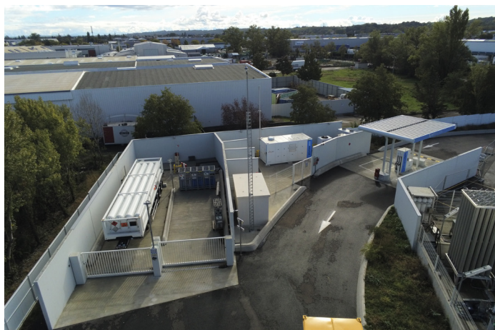
© HYmpulsion, station hydrogène à Saint-Priest, vue aérienne
